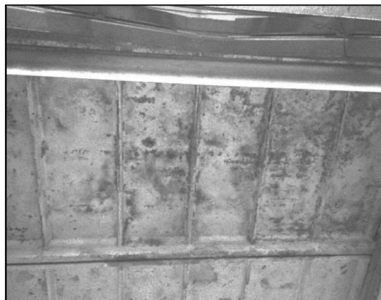
б) Шелушение бетона плит покрытия
