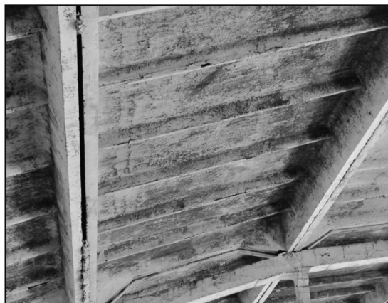
а) Следы замачивания плит покрытия
