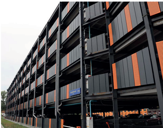
Рис. 3. Паркинг в Южном Медведково (вид с запада). Перфорированные металлические листы в виде ограждающих конструкций, трубопроводы ливневой канализации на фасаде, открыто проложенные электрические кабели (фото авторов)
