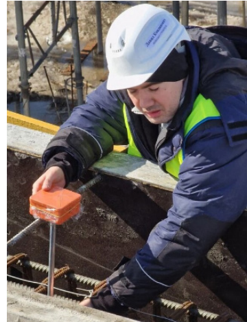
Рис. 6. Установка температурных датчиков
