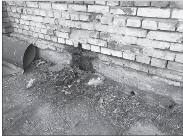
Рис. 3. Разрушение бетона полки фундаментной балки, обнажение и коррозия арматурного каркаса
