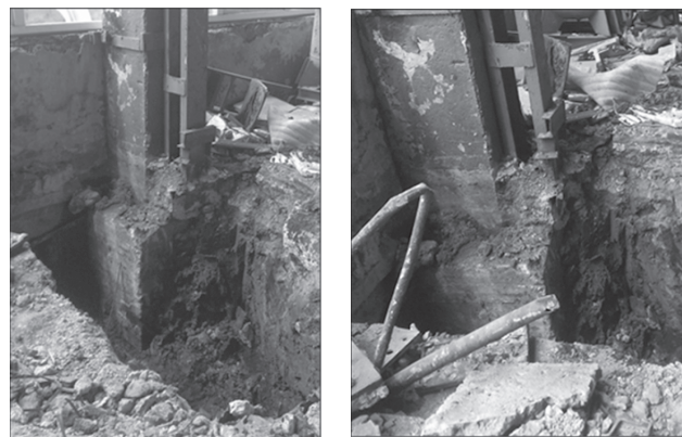
Рис. 1. Отсутствие фундамента под металлическими колоннами
