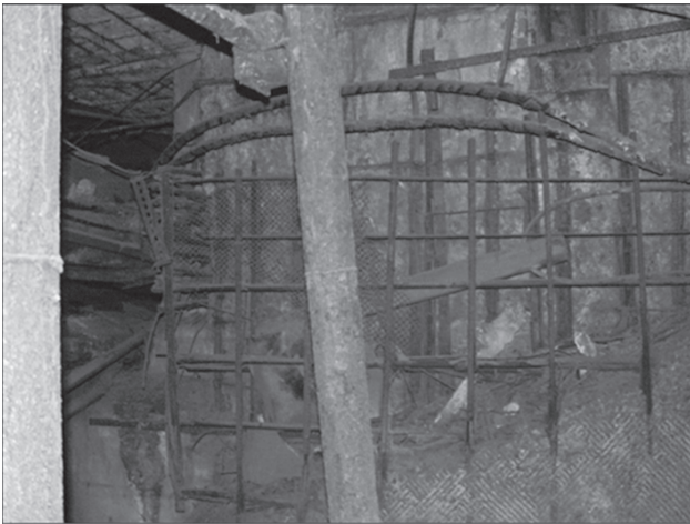
Рис. 2. Незавершенное усиление фундамента колонны, коррозия каркаса усиления железобетонного фундамента
