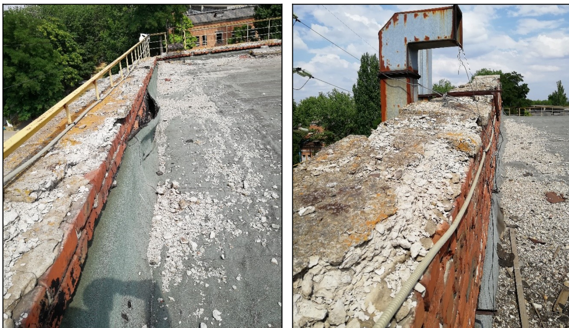
Рис. 10. Разрушение железобетонных парапетных плит
