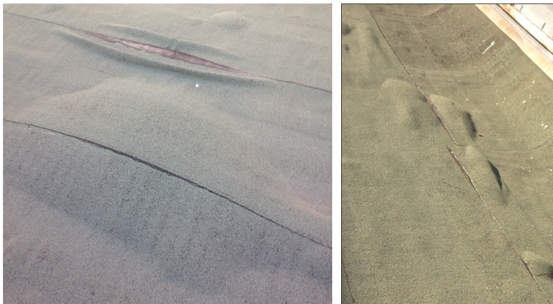
Рис. 1. «Дутики» и непроклеи рулонного гидроизоляционного ковра
