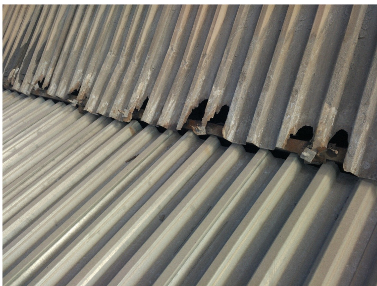
Рис. 8. Сквозная коррозия металлической кровли
