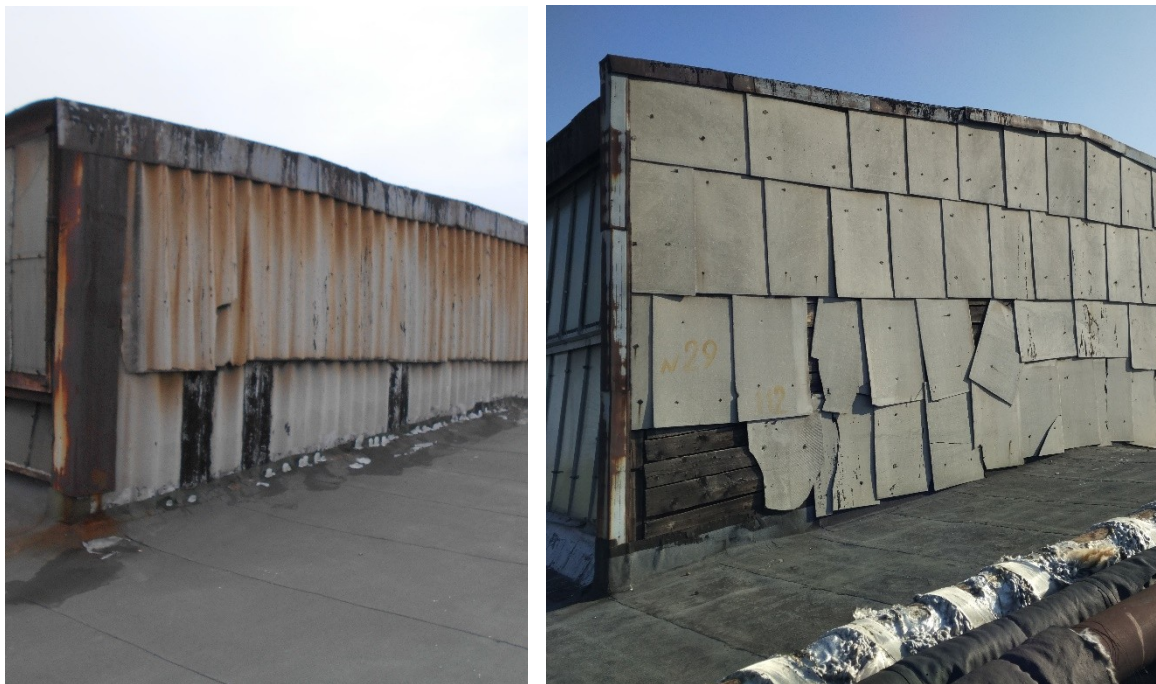
Рис. 15. Разрушение асбестоцементного ограждения фонарей
