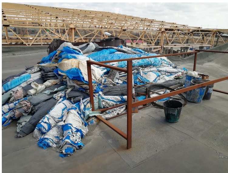
Рис. 5. Захламление кровли оставленными строительными материалами
