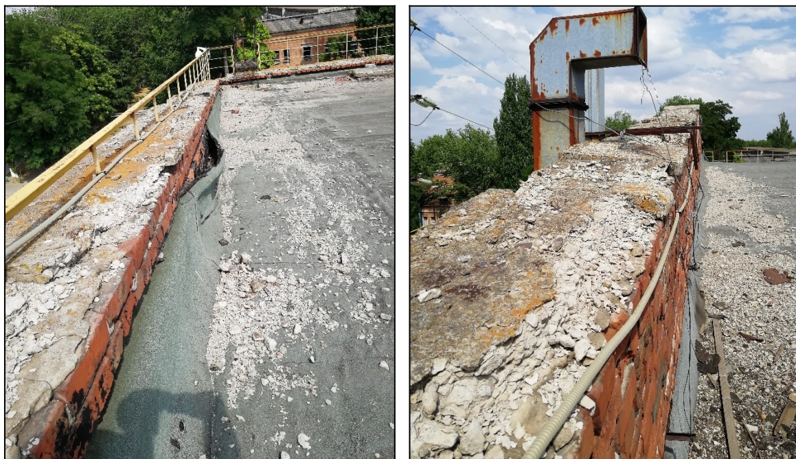
Рис. 10. Разрушение железобетонных парапетных плит
