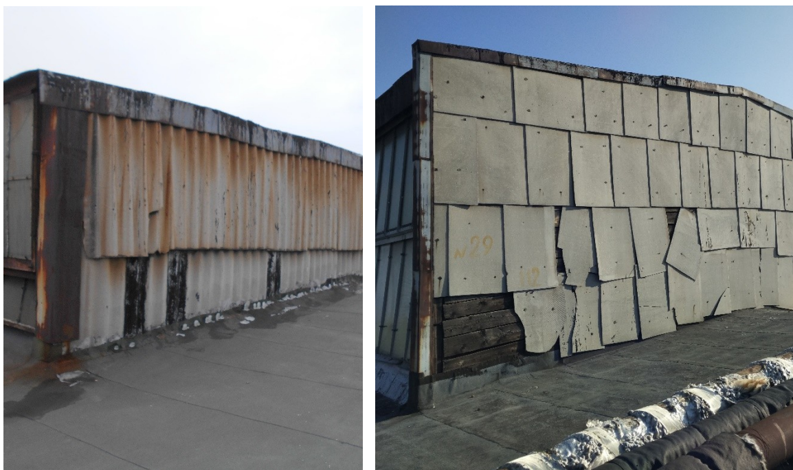
Рис. 15. Разрушение асбестоцементного ограждения фонарей
