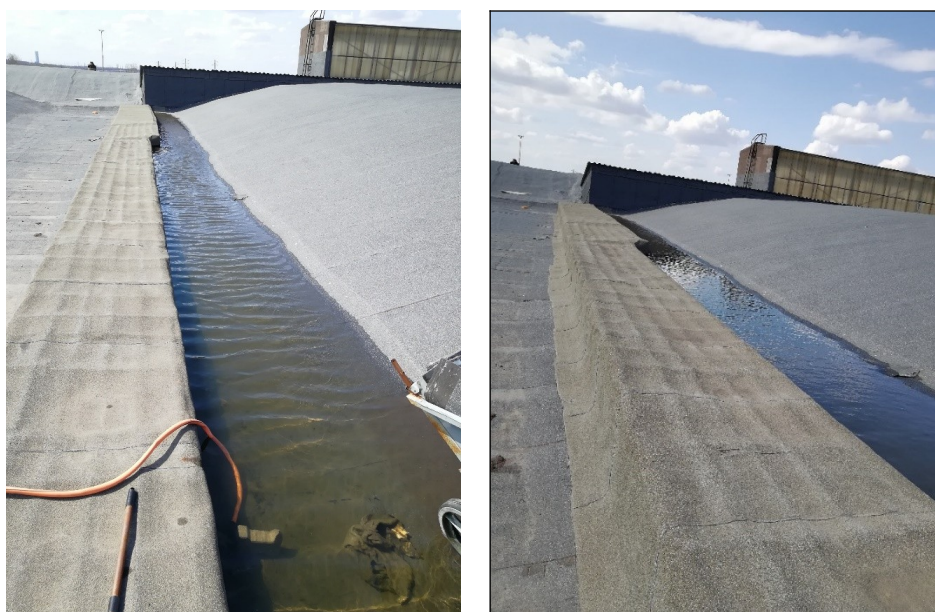
Рис. 12. Отсутствие воронки водостока, застой осадков на кровле
