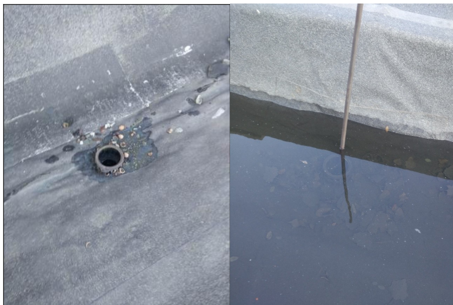
Рис. 11. Отсутствие колпака на воронке ливневого водостока, засорение системы ливневого водостока
