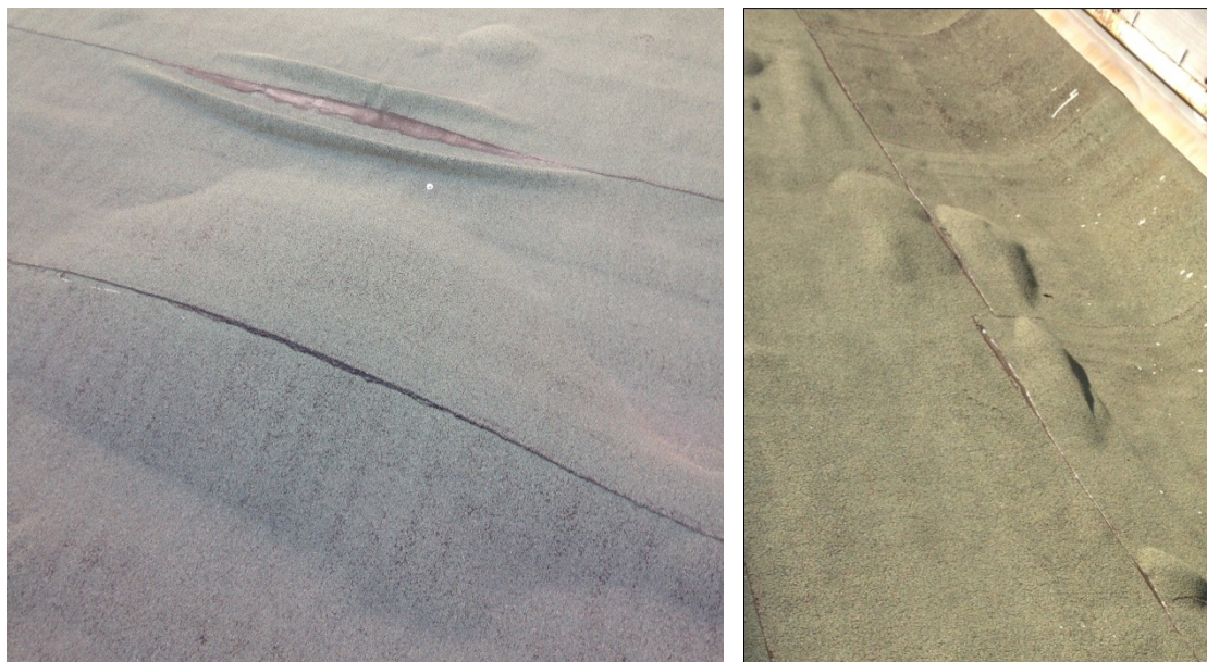
Рис. 1. «Дутики» и непроклеи рулонного гидроизоляционного ковра
