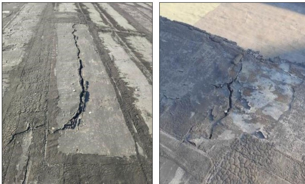
Рис. 2. Трещины и разрывы рулонного гидроизоляционного ковра
