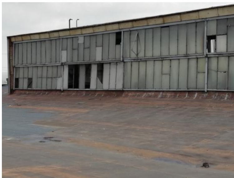
Рис. 13. Разрушение оконного заполнения светоаэрационных фонарей
