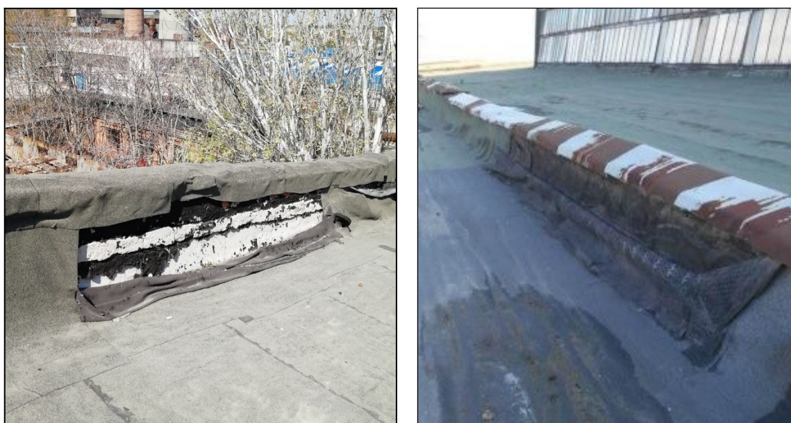
Рис. 4. Отклеивание рулонного ковра от вертикальных поверхностей
