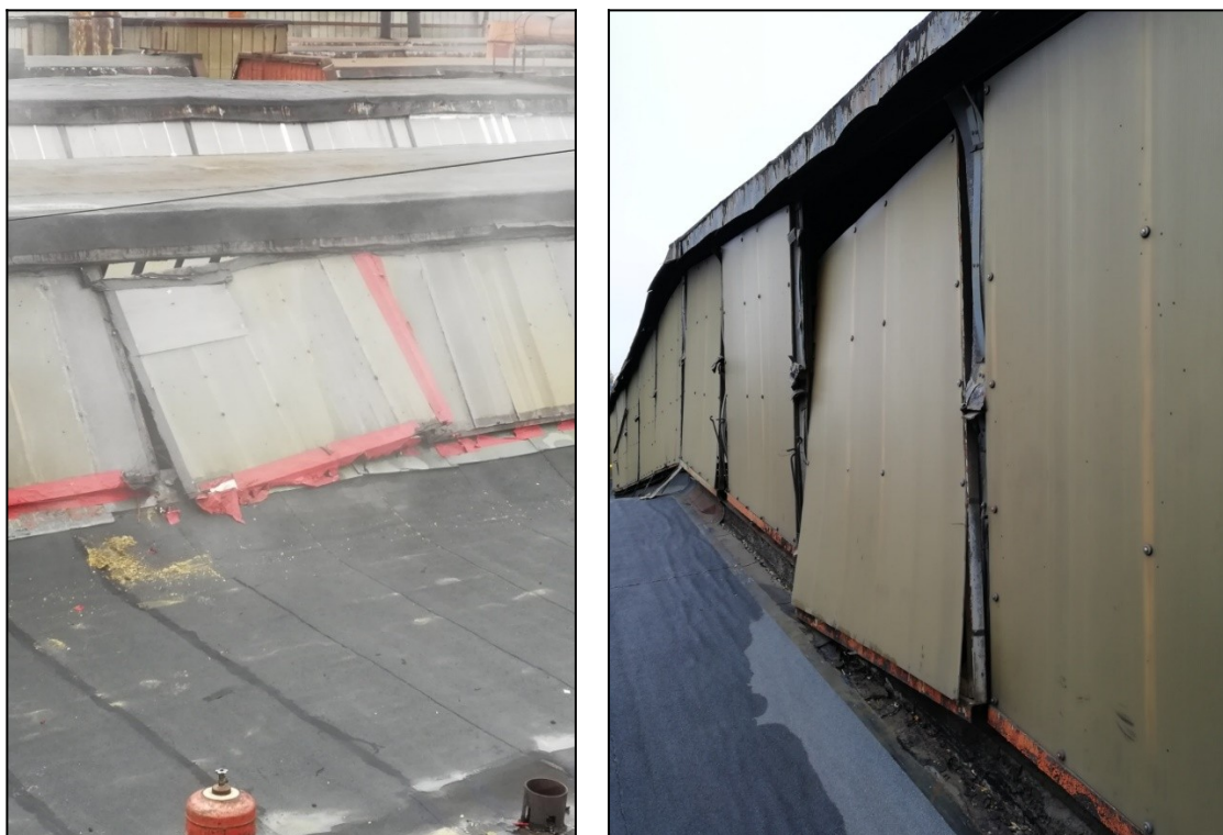
Рис. 14. Отрыв оконных ставней фонаря
