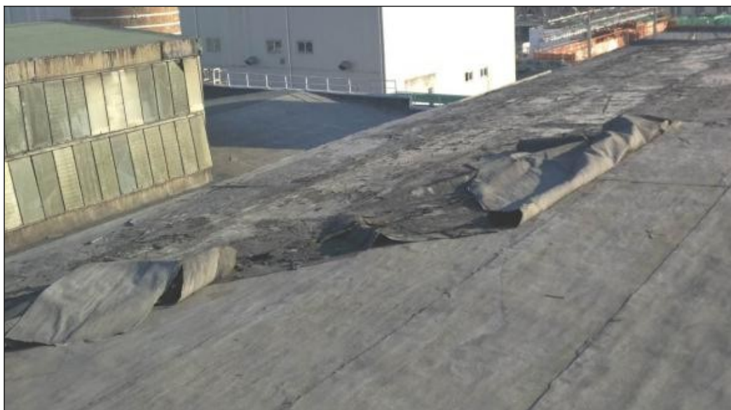
Рис. 3. Отрыв, отслоение кровельного материала
