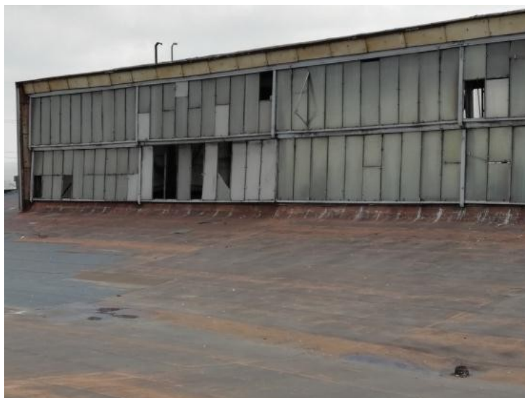
Рис. 13. Разрушение оконного заполнения светоаэрационных фонарей
