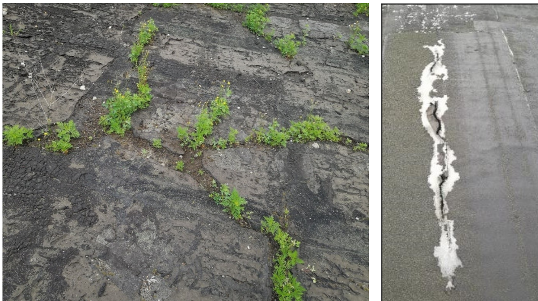
Рис. 6. Износ конструкций кровли
