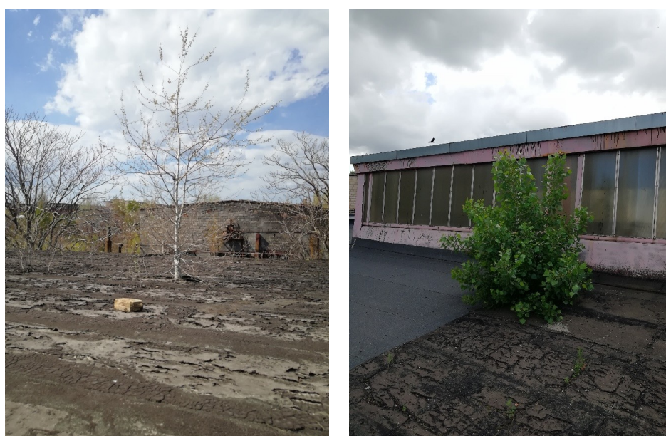
Рис. 7. Прорастание деревьев на кровле
