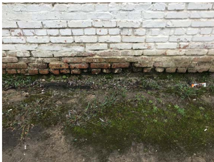
Рис. 3. – Разрушение кирпичной кладки цоколя на глубину до 50 мм
