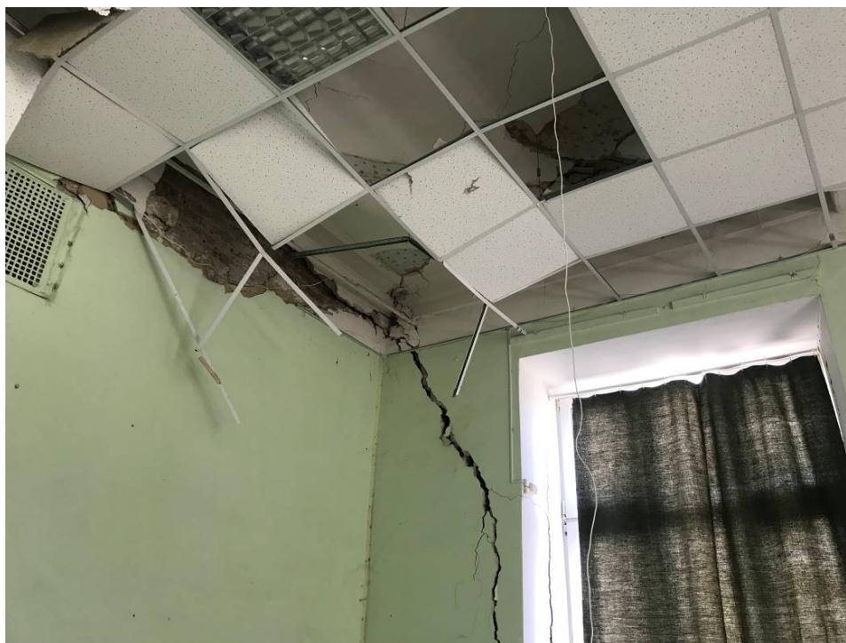
Рис.1. – Наклонные трещины в наружной стене шириной раскрытия до 50 мм
