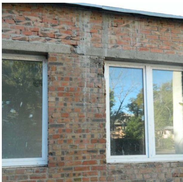
Рис. 4. – Разрушение кирпичной кладки простенков наружных стен
