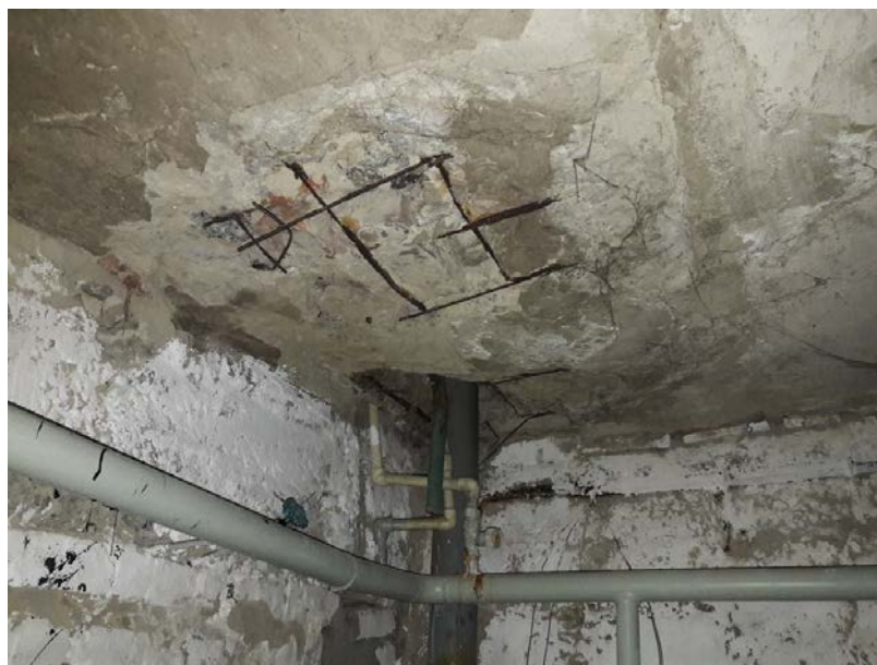
Рис. 2. – Разрушение защитного слоя бетона плит перекрытия подвала, оголение и коррозия арматуры. Необустроенное технологическое отверстие
