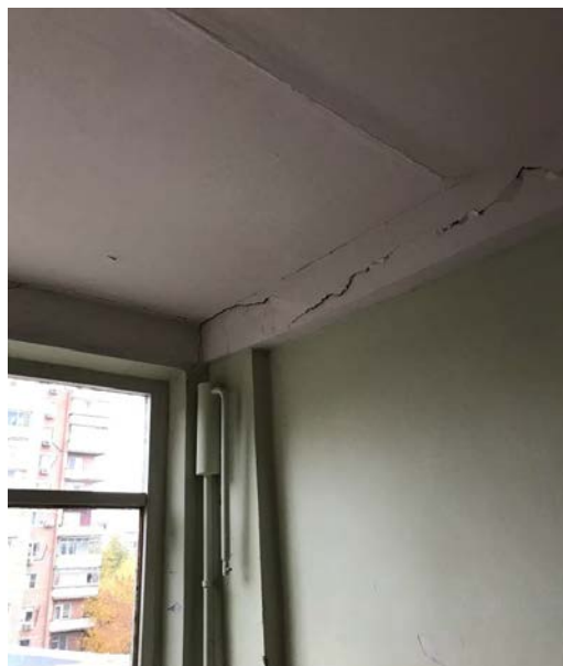
Рис. 5. – Недостаточное опирание плит покрытия (70 мм)
